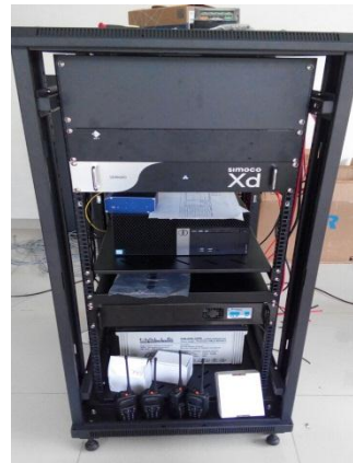
(b) Perangkat sistem repeater pada indoor close rack
