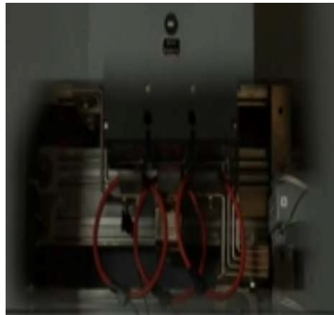
Gambar 3. Pengukuran Harmonisa Pada Outgoing Transformator 1000 kVA Ke Cubicle Panel Dengan Menggunakan Fluke 1735 Three-Phase Electrical Energy Logger
